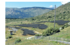
Engie Green Planta fotovoltaica bifacial
