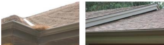
Αριστερά, συσσώρευση πευκοβελονών στην υδρορροή. Δεξιά, σχετικά καθαρή στέγη.
