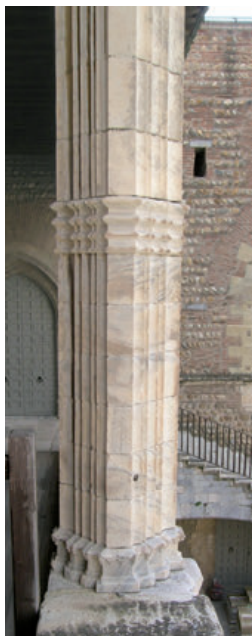
36 - Pilier conservé au sud de l'arcade du porche de la chapelle Sainte-Croix. Le marbre cipolin au grain plus fin est moins altéré que sur la façade, surtout à la base qui est sûrement d'origine.
