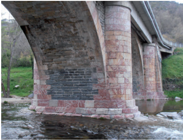
48 - Pont moderne dit « de Catllar », à Prades. On remarque que ce sont les marbres rouges les plus sombres et les plus homogènes (carrière de Corneilla-de-Conflent) qui sont préférentiellement exposés à l'érosion au plus près du fleuve et qu'ils ont bien résisté depuis plus de deux siècles. La base de la voûte est faite d'une roche sombre schisteuse et le reste en granite, concurrent le plus sérieux pour résister aux assauts de la Têt, mais dont l'emploi est ici marginal. En 1876, la crue a complètement déchaussé le radier. La partie haute des piles a été rajoutée après 1960 pour élargir la voirie (cl. C. Respaut, AAPO).
