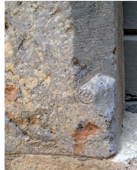
17 - Congé de chanfrein délicatement sculpté d'une petite rosace sur la porte H6 de la cour de la reine qui ne livre pas de signes lapidaires. Le matériau est ici le plus sombre de la « brèche orientale » de Baixas, dressée à la gradine dont on voit les traces en négatif sur le chanfrein.
