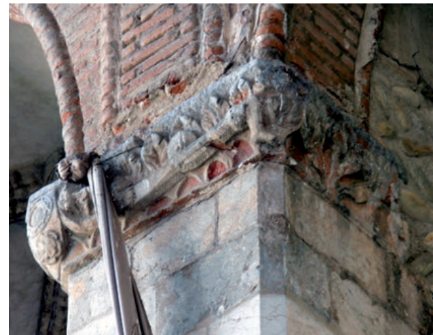
25 - Église des Carmes. Détail des moulures en brique, avec quelques adhérences de stuc, à la base de l'arc diaphragme de la voûte couplé aux arcades des premières chapelles de la face méridionale. Elles reposent sur un tailloir, sculpté comme un chapiteau dans la brèche bleue de Baixas et perché à 11 m de hauteur sur un pilastre de même roche (restauré). Des traces de peinture rouge entourent le motif principal (pour le rendre visible), soit un serpent deux fois enroulé, mais passant avec rigidité sur des feuilles pour « engouler » un petit quadrupède. À gauche, un écusson porte une rose et le sceau de Salomon. L'affreux linge qui pend, accroché à un fil de fer passé dans une fente de la pierre, est un lambeau d'« aménagement » récent dont la fonction nous échappe (cl. C. Respaut).
