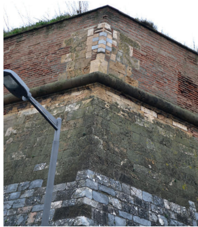
24 - Bastion Sainte-Barbe, angle extérieur en pierre de taille de Les Fonts et Baixas, surmonté par les armes du duc d'Albe, état actuel (cl. de l'auteur).
