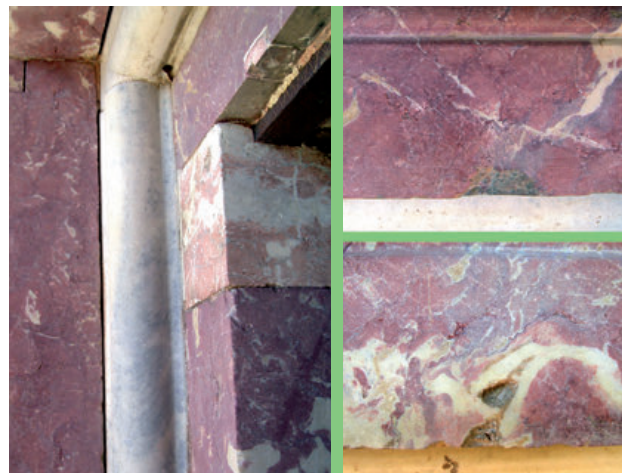
56 - Façade de la chapelle haute au château royal. À gauche, détail de l'angle supérieur gauche de la fenêtre nord. À droite, détails des sortes de géodes dans le marbre pourpre et différence des marbres blancs du tore (patine ivoire en bas).
