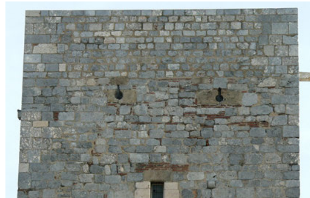
16 - Réfections sur la façade occidentale de la tour de l'hommage. En bas, ajout d'un linteau millésimé du XIX e siècle et plus haut deux bouches à feu en cargneules datant probablement du XV e siècle (cl. Agnès Marin, 2007).
