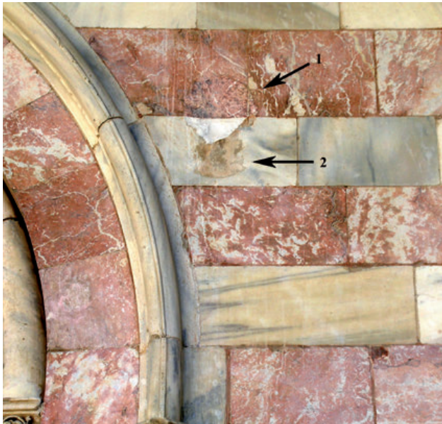
10 - Possible trace de boulet sur la façade de la chapelle haute (n° 1). On remarquera au niveau du creusement dans les deux parements, l'éclat et la fraîcheur des marbres nettoyés lors des restaurations par rapport à la curieuse coulure brune qui a imprégné la patine du marbre blanc juste en dessous, sans disparaître (n° 2).
