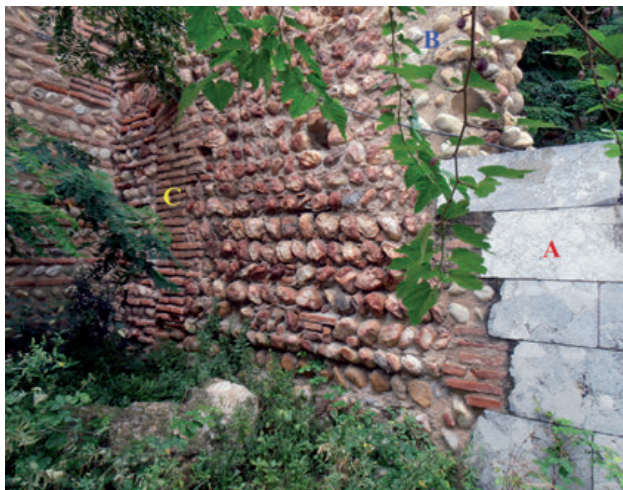
24 - Église des Carmes. Contrefort interne servant de mur à l'une des chapelles méridionales. La couleur des quartz brûlés tranche avec les parties restaurées avec des galets de l'alluvion actuelle (en B) et avec les parements neufs en brèche de Baixas (A). L'encadrement des portes est en briques (C) et le mur méridional comporte des chaînages en terre cuite (cl. C. Respaut).
