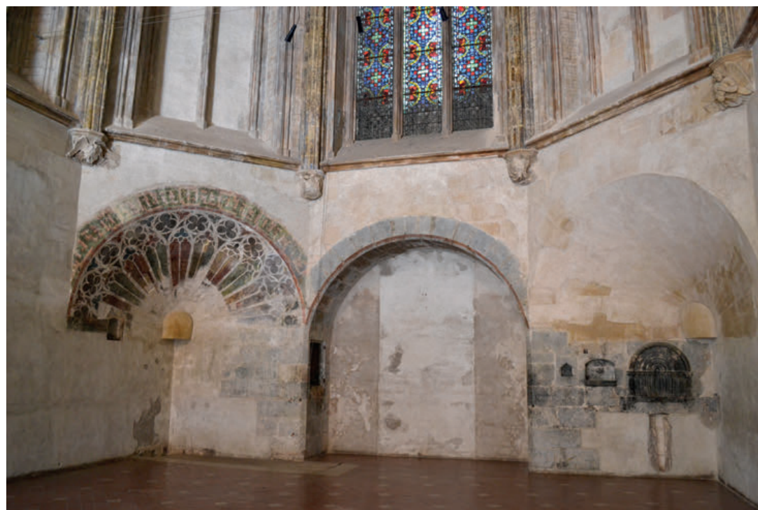
2 - Pintures murals de la capçalera de la capella de la Santa Creu amb la vitralleria fingida a la trompa.
