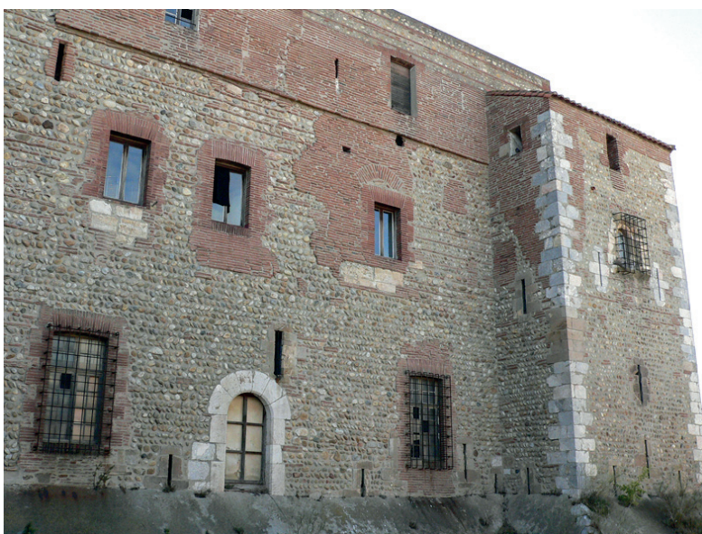
17 - Aile est. Façade extérieure. Partie nord, non restaurée. Cette façade est un exemple représentatif de l'état du bâti avant les restaurations de S. Stym-Popper. Cl. A. Marin.
