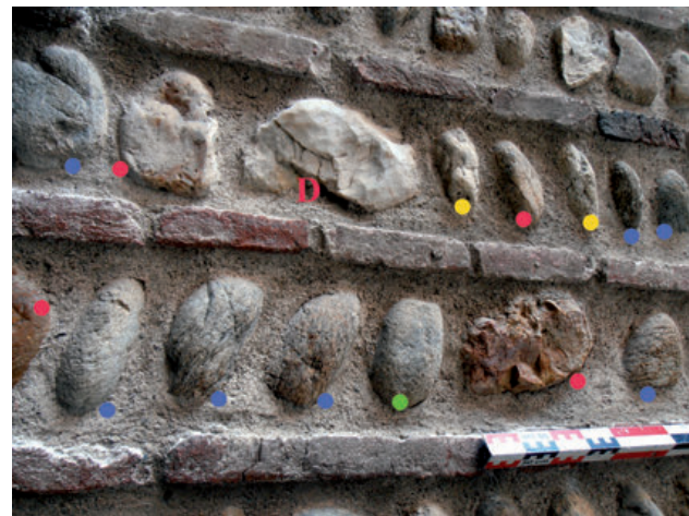
5 - Château royal de Perpignan, mur sud du logis du roi, partie rejointoyée et restaurée sous la direction de Stym Popper (M18, tableau 3). Parmi les galets de gneiss (bleu), de granites (vert) ou de quartz blanc (jaune) d'aspect frais et les quartz patinés (rouge), se remarque un dreikanter (D) où l'on distingue les facettes d'usure creusées par les vents chargés de sable. Dans ce cas, c'est l'éolisation qui fait disparaître la patine.
