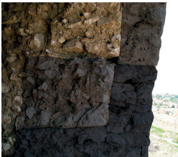
6 - Chloumoutzi-Clermont, hexagone, fissure au mur nord : chemin de ronde et parapet des phases 1 et 2.
