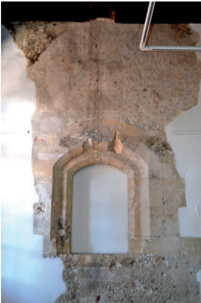
24 - Vestige d'enduit à décor peint de faux appareil au-dessus et au-dessous de la fenêtre à arc segmentaire de la façade primitive de l'aile nord (chambre de parement supposée). Cl. O. Passarrius.
