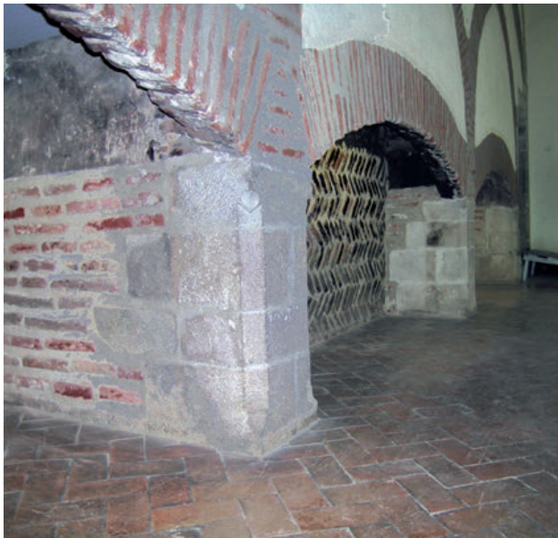
22 - Cheminées de la salle de Majorque, au château royal. Le grès utilisé pour les piliers et les grandes briques des voûtes ou celles qui tapissent les conduits sont des matériaux décoratifs apparents, mais surtout appropriés pour mieux résister au feu.
