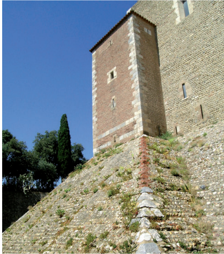
4 - Tour de l'angle nord-ouest du château où l'on remarque que la brique a totalement remplacé les galets du rempart majorquin jusque sur l'angle de l'escarpe qui avait été arraché. Les roches du bâti antérieur apparaissent en réemploi sur les angles de la tour et, à la base, au niveau du chaînage des parements, avec l'introduction d'une canonnrière en place des anciennes meurtrières, bien visibles à droite (voir ill. 7, n° 5).
