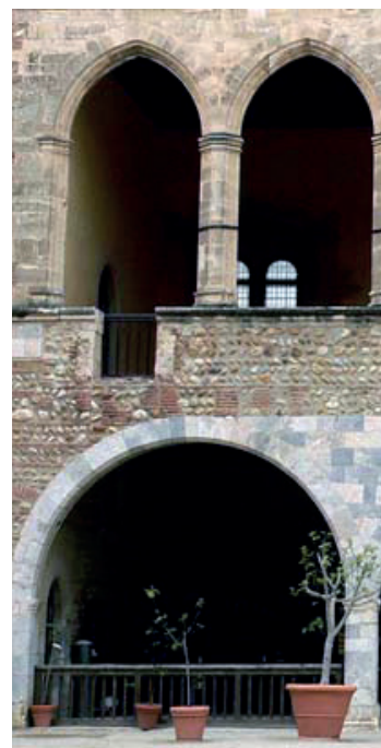
6 - Aile ouest. Façade sur cour. Accès du « palais blanc » à la galerie en bois qui surplombait la cour. Les bouchages en brique marquent l'emplacement des supports de la galerie. Cl. B. Pousthomis.
