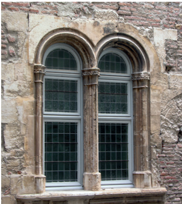
22 - Seule baie géminée non restaurée ou remplacée. Étage du mur nord de la cour du roi. Cl. B. Pousthomis.
