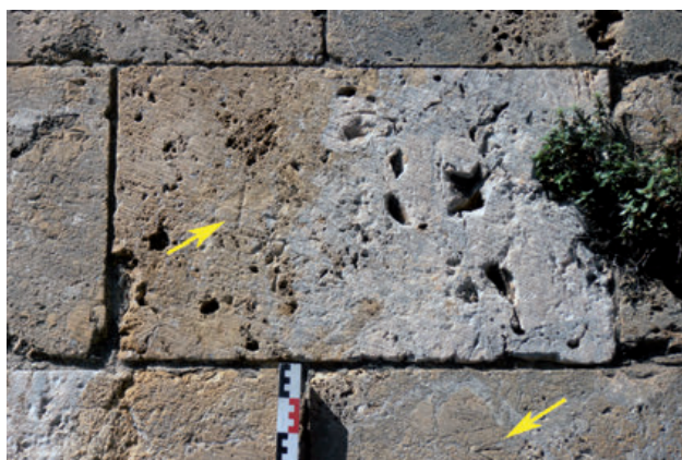
25 - Contrefort du clocher sud de la cathédrale d'Elne réalisé par G. Sagraera au début du XV e siècle avec ses ouvriers de Baixas. La cagneule blonde est visible sur le parement central à gauche avec un signe lapidaire. La partie de couleur grise pâle à violine, creusée de grosses cavités, est un calcaire (dolomitique ?) qui semble un peu bréchique. Les signes lapidaires, tel celui du bas, en forme de Z, sont les mêmes que pour les brèches bleues du clocher de Baixas (XIV e siècle).
