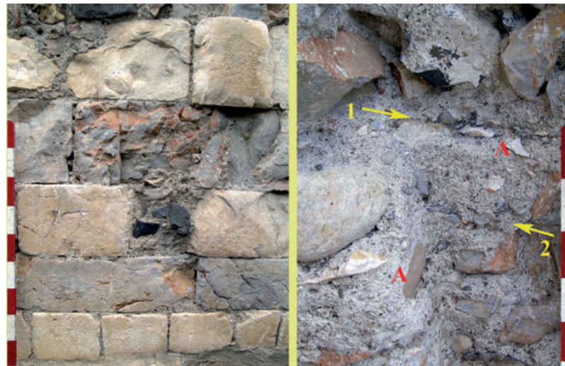
28 - Église romane ancienne d'Espira-de-l'Agly, détail de l'architecture en bandes bicolores sur l'extérieur (vue de gauche où l'on remarque la belle qualité du marbre blanc saccharoïde et celle, médiocre, du calcaire bleu, très fissuré). Vue de droite les éclats de marbre blancs (flèche n°1 et A) et bleus (flèche n°2) pris dans le mortier de chaux à l'intérieur de l'abside.
