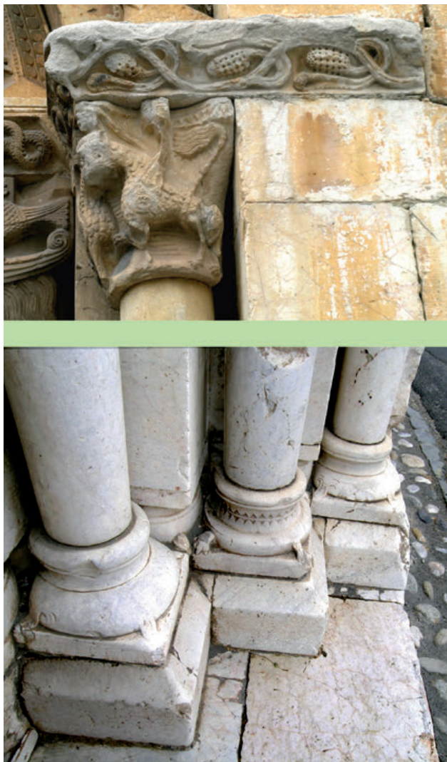
29 - Portail de l'église fortifiée d'Espira-de-l'Agly. En haut le marbre homogène légèrement bleuté à grisâtre du tailloir et des chapiteaux s'oppose à la blancheur des parements, cependant fissurés (filets rougeâtres typiques du marbre d'Estagel). En bas, base des belles colonnes monolithiques choisies parmi le marbre le plus homogène, légèrement gris : comparer avec la pierre du seuil qui est également taillée dans le même faciès, mais où le réseau de microfissures apparaît grâce à leur altération jaunâtre.
