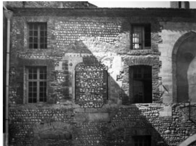
11 - Façade de l'aile ouest sur la cour, après piochage des enduits : détail de la partie sud, à l'étage : la baie du XIV e s. apparaît entre les percements militaires. Photo Stym-Popper.
