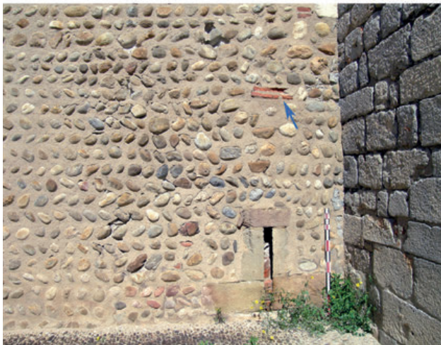
10 - Première phase du chantier au château royal à la base de la courtine ouest. La vue du bas montre l'agencement des petits galets plus ou moins disposés en épi, les parements de brèche bleutée de Baixas de la face nord de la tour de l'hommage, légèrement encastrés dans celle-ci et une archère condamnée en grès acide du Boulou. La flèche bleue pointe un linteau de grandes briques superposées qui renforçait un trou de boulin. La vue supérieure agrandit la zone située à droite de la flèche où se voit un éclat de taille en brèche bleue (BB) lié à l'insertion du mur de la tour, des galets de quartzite (QZT), de quartz blanc (QB), de granite (GR) et de gneiss (GN) d'aspect assez frais. Ils sont mêlés à des gneiss altérés (GNA) et des quartz patinés (QP). Sous le mortier récent (beige) l'érosion a fait apparaître le typique mortier de chaux médiéval. Les flèches indiquent les nodules crayeux témoignant de roches calcaires incomplètement brûlées.
